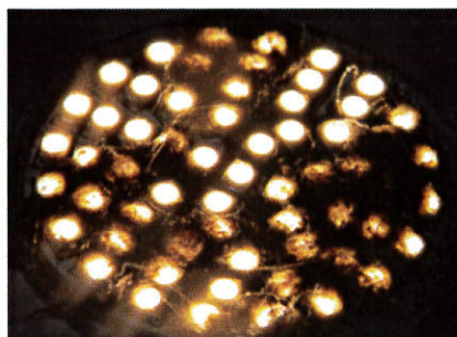
Thermische Überhitzung durch erhöhte Schmutzbelastung [Fas16a]
